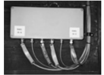
Profibusbox für zwei Rauchmelder
