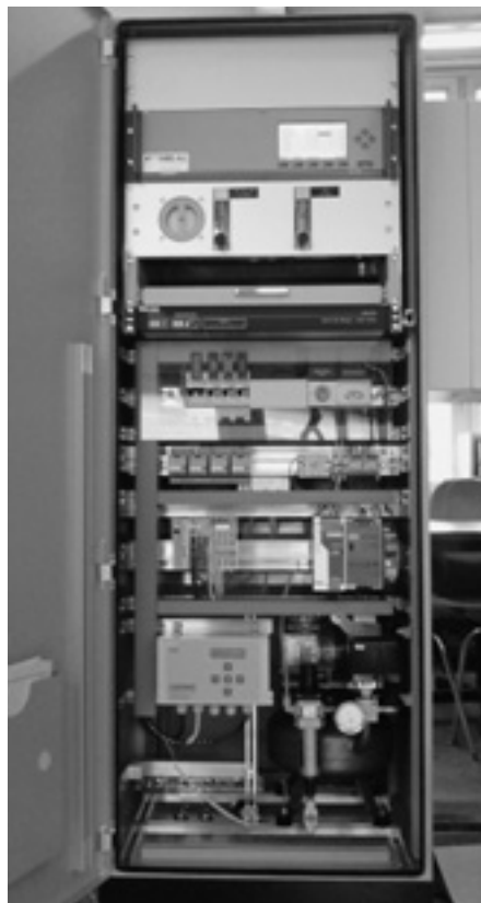
Schutzschrank der Brandüberwachung des Eisenbahntunnels
