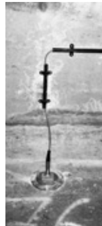
Rauchmelder in der Zwischendecke zum Fahrraum
