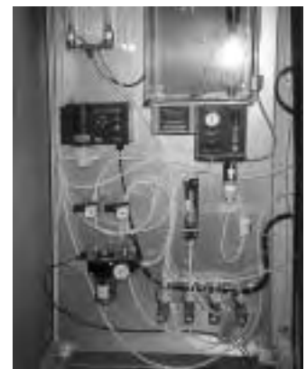
Die gesamte Gasaufbereitung
